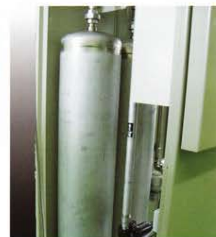
③バッファータンク
